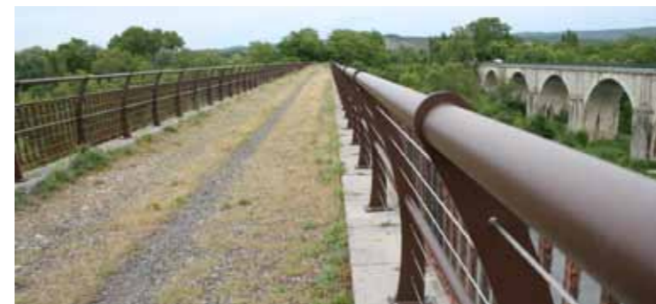
Les travaux déjà réalisés (ici gardes-corps à Sampzon) dévoilent de belles perspectives, en attendant les finitions ultimes.
